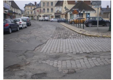
Le centre ville ou la gare ? La majorité PS a choisi la gare. Ici le cœur de ville place Cantrel dans un bien triste état
