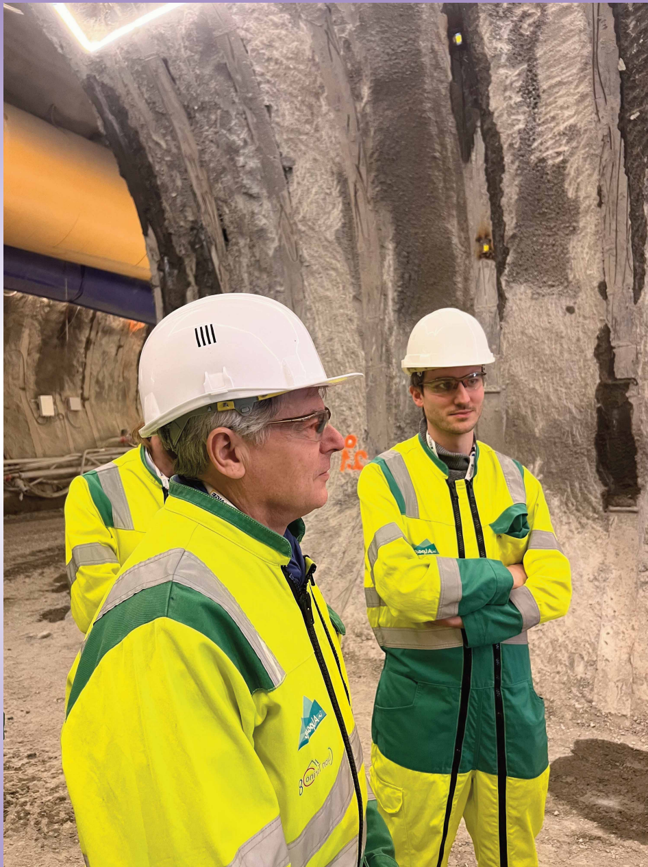
"Léon Deffontaines, tête de liste aux élections européennes et Fabien Roussel, secrétaire national du PCF en visite sur le chantier du Lyon-Turin" 08/02/24 Photo : Adeson Ngoumnaï
